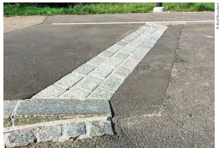
Schon bald Vergangenheit: die Holperkante an der Gäustrasse in Hägendorf.
